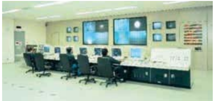
清掃工場中央管制室
