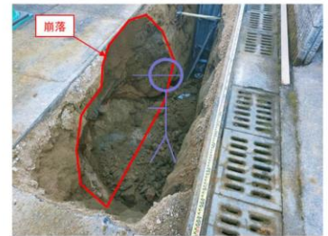
側面の岩塊が崩落し、作業員が埋められた。
