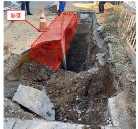
側面の地山が崩落し、作業員が埋められた。
