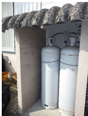
③プロパン保管場所：転倒していないか 漏れていないか
