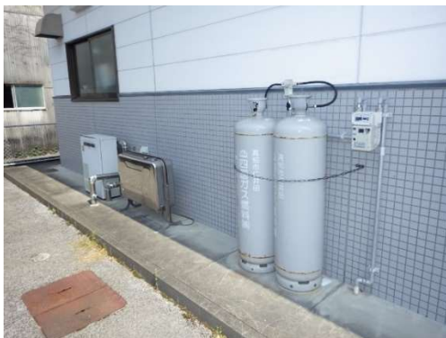
③ガス保管場所：転倒していないか 漏れていないか
