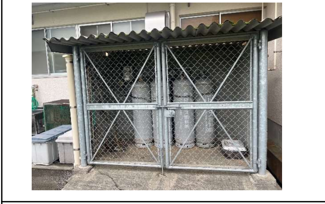
②プロパン置場：転倒していないか、 ガス臭くないか確認
