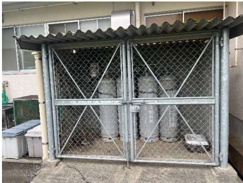
②プロパン置場：転倒していないか、 ガス臭くないか確認
