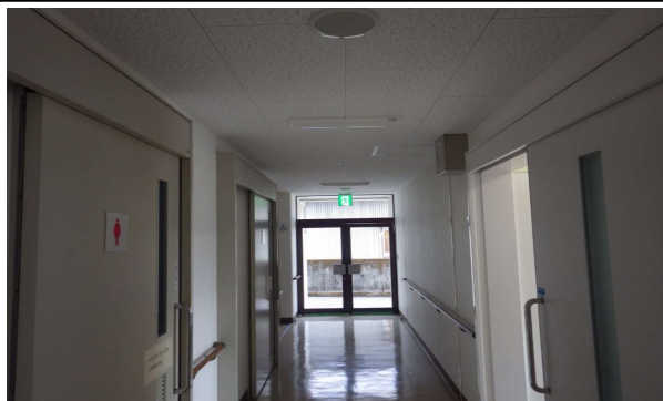
①天井・壁：照明の落下、窓ガラスの落下はないか確認
