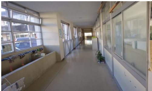
①廊下：窓ガラスに割れはないか、照明などの落下はないか確認
