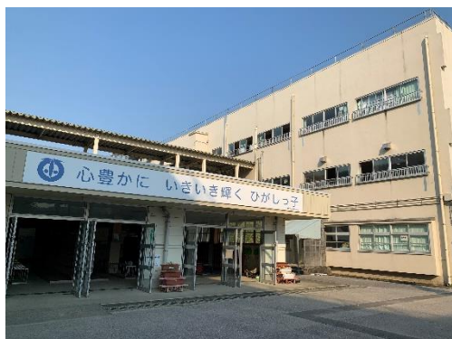
①外壁の落下、窓ガラスの割れはないか 確認（施設全体を確認）
