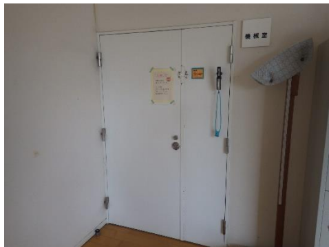
③機械室：漏電が無い確認
