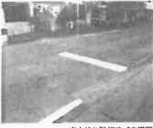
抜本的な改修すべき道路
