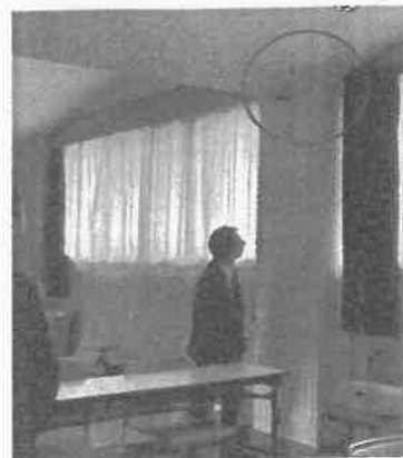
雨漏りのする高知商業高校音楽室の視察に行っていました。
