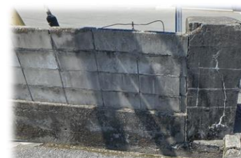
倒壊の危険性が高いブロック塀
