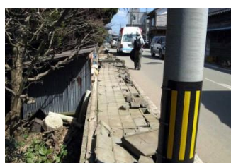
ブロック塀倒壊
