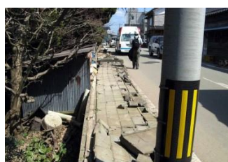
ブロック塀倒壊
