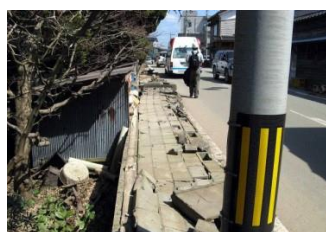
ブロック塀倒壊
