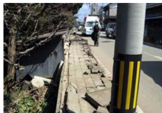
ブロック塀倒壊
