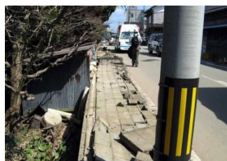
ブロック塀倒壊
