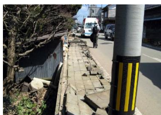
ブロック塀倒壊
