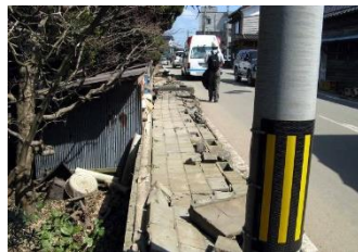
ブロック塀倒壊
