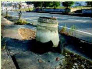
液状化によるマンホールの浮き上がり
