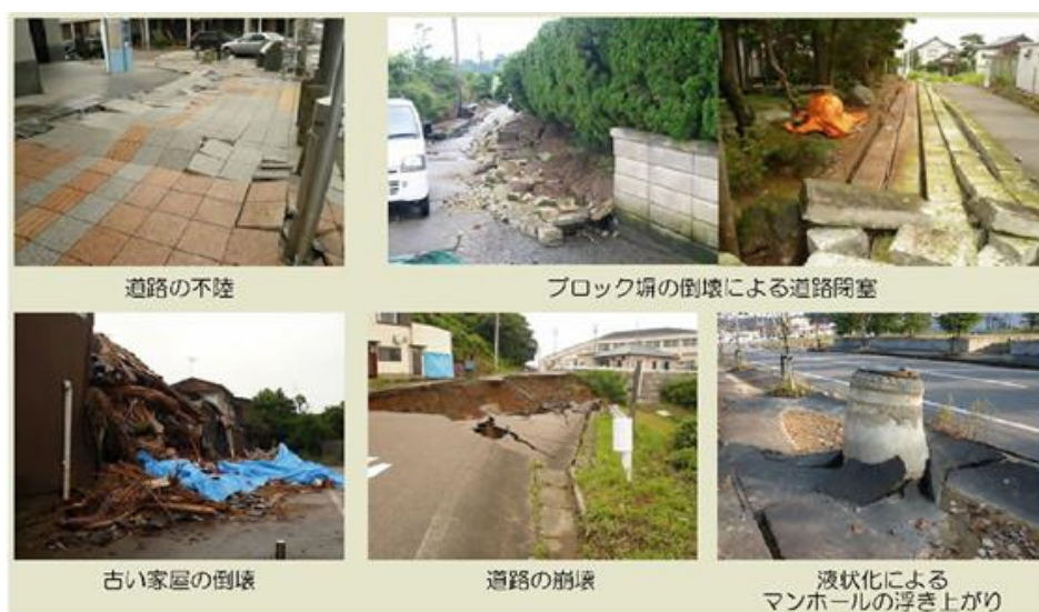
図7 揺れによって想定される被災状況
