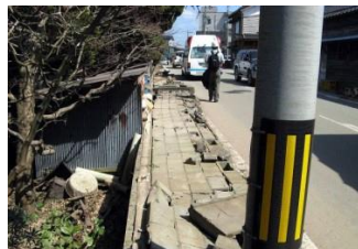
ブロック塀倒壊
