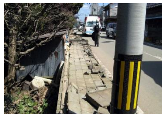
ブロック塀倒壊
