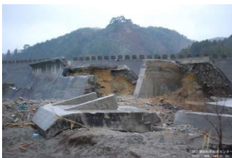
防波堤の崩壊
