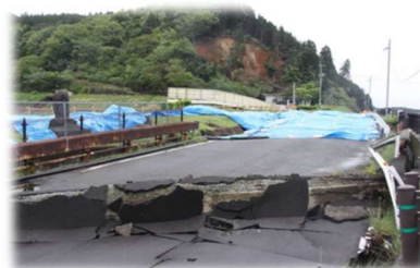
－地震後の段差の発生－
