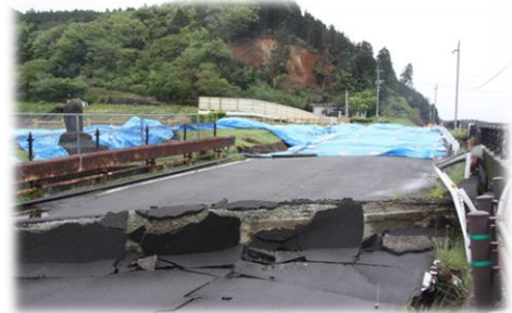
—地震後の段差の発生—
