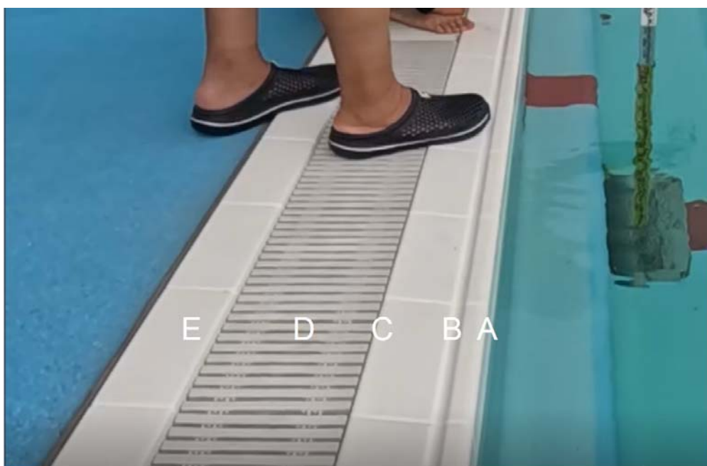
図4 南海中学校のプールのオーバーフロー
